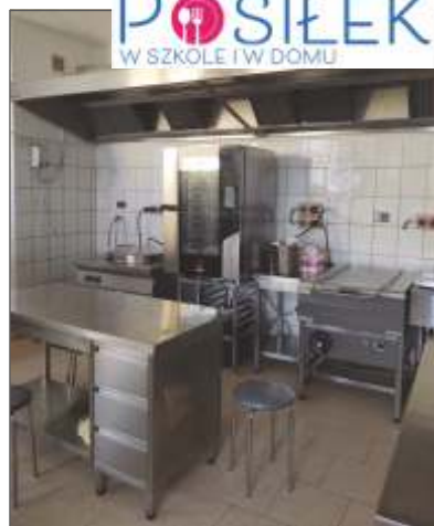
Pracę szkolnej kuchni w Żelnie usprawnia nowe wyposażenie.
